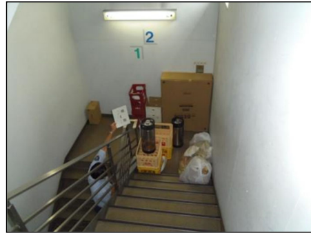
階段に物件が置かれている様子
